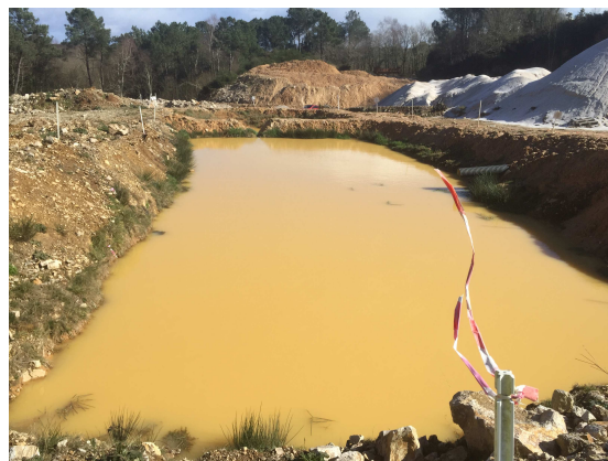
Le double bassin de décantation
